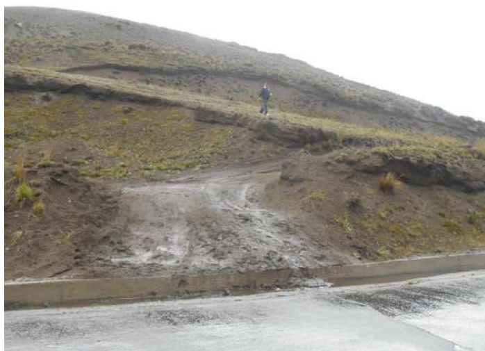
Figura 5.16 Movimiento de masa en la via Riobamba a Guaranda
